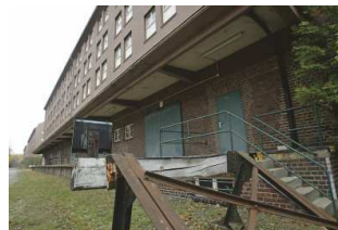
Die verlassene ehemalige Standortverwaltung an der Rabensteinstraße soll als Wohngebiet und Standort für die Lebenshilfe entwickelt werden. Über den Abriss oder den Erhalt der alten Speicher wird heftig diskutiert. Foto: t&w
